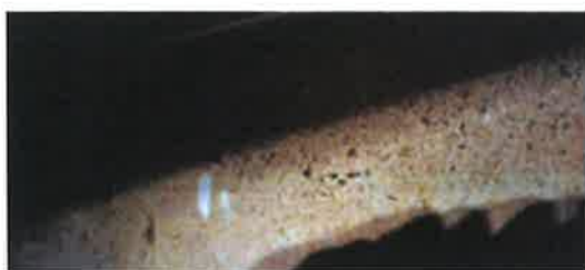
レンジ横の壁面。食用油の飛び散りがある。市販の油污れ洗剤で落としきれず。
